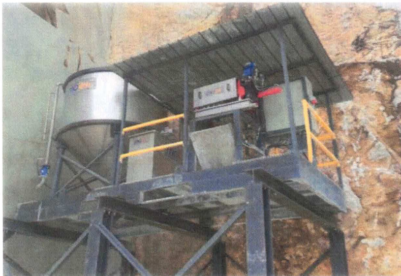
Foto della filtropressa in funzione
